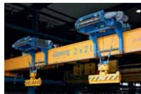
Eine Krananlage der Gloning Krantechnik GmbH aus Stöttlen für die Siemag Tecberg Gruppe. (Foto: Gloning)
