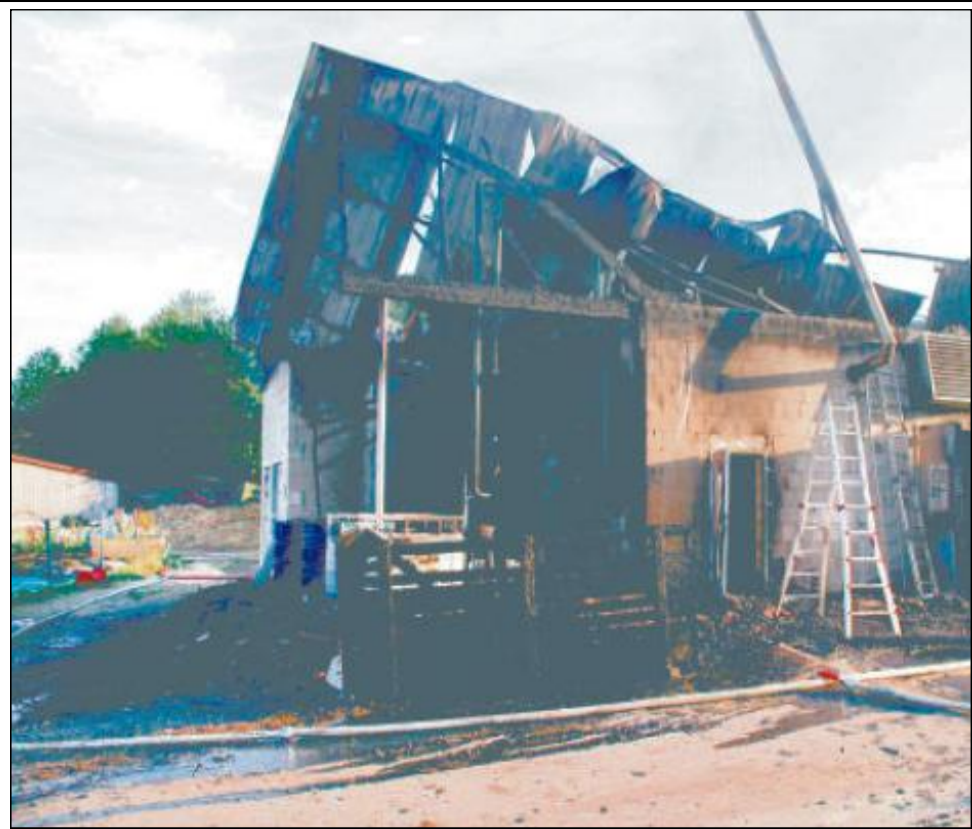
Beim Brand auf einer Biogasanlage auf einem Aussiedlerhof bei Gissigheim am Freitag wurde das Technikgebäude völlig zerstört. Der Gesamtschaden könnte ersten Schätzungen zufolge bei über einer Million Euro liegen. Foto: Gassenbauer
